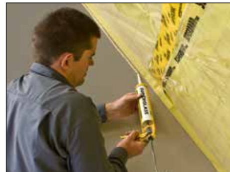
8. Mit dem SUPERGLASS-DICHTKLEBER eine 8 mm dicke Kleberaupe auf die umliegenden Bauteile wie Giebelwände und Fußpfetten auftragen und die Dampfbremsfolie spannungsfrei, als Schlaufe gefaltet, andrücken.
