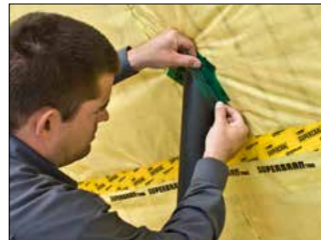
7. Anschlüsse der SUPERBRANTRIO-Dampfbremsfolie an Durchdringungen und beweglichen Bauteilen mit den Klebebändern SUPERSAN oder SUPERFORTE luftdicht herstellen. Auch mit Fertigmanschetten möglich.
