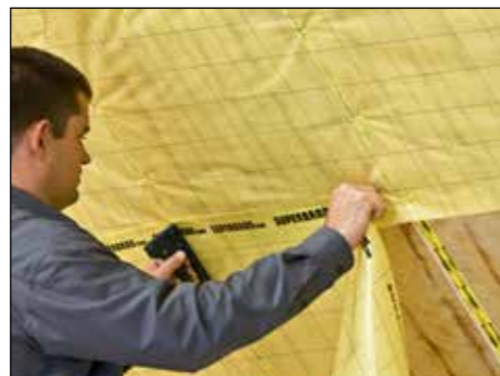
5. SUPERBRANTRIO-Dampfbremsfolie mit 10 cm Überlappung von oben nach unten gerade, falten- und spannungsfrei quer zum Sparren verlegen und mit einem Handtacker fixieren. Die beschriftete Folienseite zeigt zum Verarbeiter.
