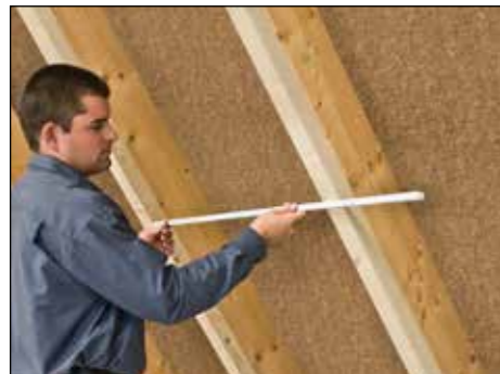
1. Abstand zwischen den Sparren und Kehlbalken ausmessen und 1 cm Klemmzugabe begeben. Bei Bedarf eine „Aufdoppelung“ der Sparren, z. B. mit hochkant aufgeschraubtem 4 x 6er Konstruktionsholz, vornehmen.
